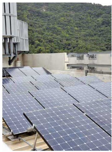
▲ 利用於 T 座天台安裝的太陽能發電板提供可再生能源
