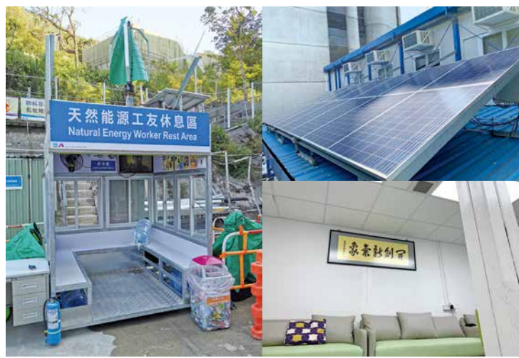
▲ 採用風力及太陽能發電，產生的電力會供應給工地的照明系統、工地辦公室及工友休息區使用。
